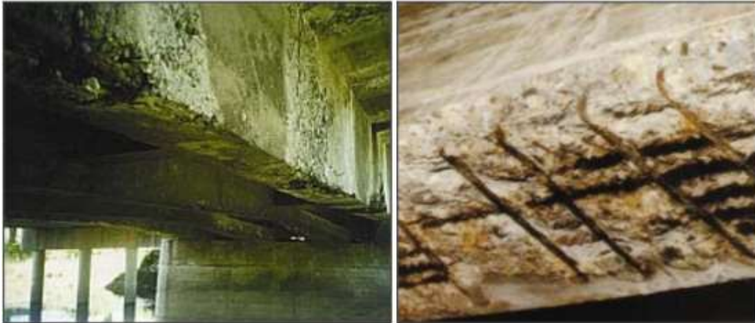
شکل ۲ نمونه‌ای از آسیب دیدگی تیرهای بتنی
