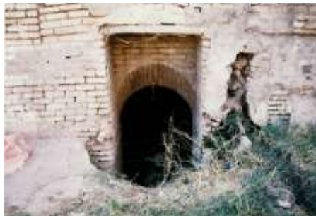
شکل ۱۷- آسیب های وارده به بخشی از نمای ساختمان (ماخذ: میراث فرهنگی)
